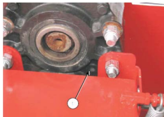
Проверка масла в редукторе
