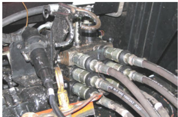
Подключение гидравлики и электрики
