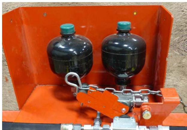
Seul le personnel qualifié doit procéder à l'entretien des accumulateurs
